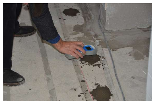
Tarkistusmittaus asentamisen jälkeen
