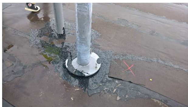
Katon läpiviennit ovat riskipaikkoja kosteusvauriolle
